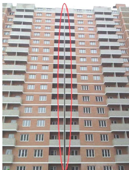
Рисунок 2 – Осадка здания в Краснодаре
