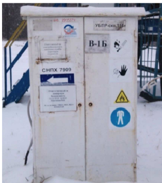
Рисунок 8 – Установка блочной (непрерывной) подачи реагента
