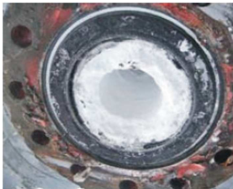
Рисунок 4 – Ледяная пробка в фонтанной арматуре скважины
